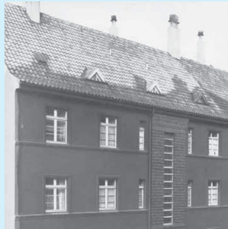
Dichte Dächer hatten beim Bauverein in den Jahren nach dem Krieg Vorrang.
