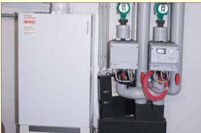
Blick auf eine Gastherme - alle WBG-Horst Wohnungen sind mit Gasheizungen ausgestattet worden.
